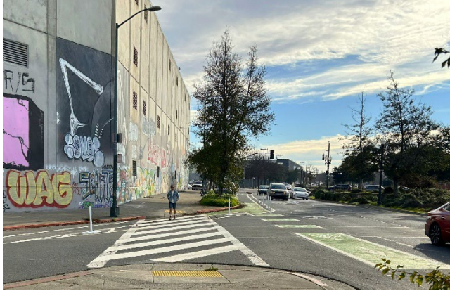
Postes montados en superficie junto a carriles bici en Mandela Pkwy
